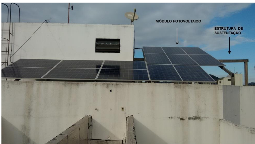
Fotografia 1: Sistema fotovoltaico da residência em estudo. Fonte: próprios autores.
