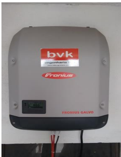
Fotografia 2: Inversor instalado na residência em estudo. Fonte: próprios autores.
