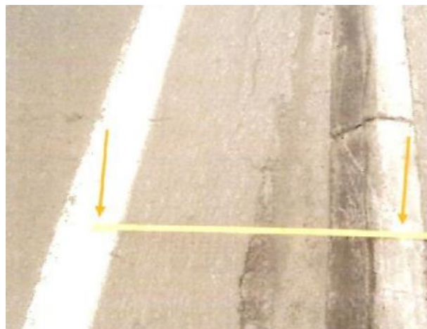
Figura 03: Verificou-se que a distância entre a linha de bordo e o meio fio apresenta-se com variações. No ponto em que constatou maior comprimento, a medição realizada no local foi de 0,45 m entre a linha de bordo e o meio fio.
