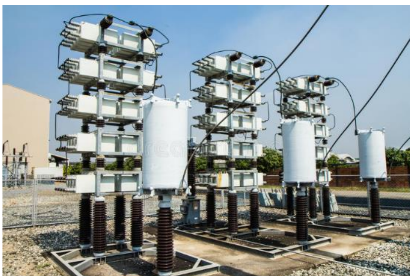
Figura 4 – Banco de Capacitores
