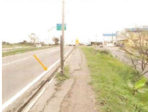
Figura 04: Demonstração da ausência de acostamento no km 264 e imediações - sentido decrescente.
