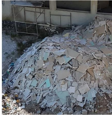
Figura 6: Resíduos de drywall
