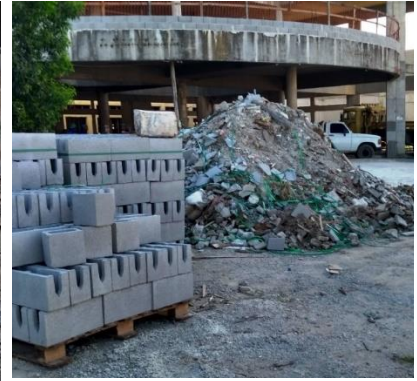
Figura 7: Resíduos de argamassa, blocos e concreto
