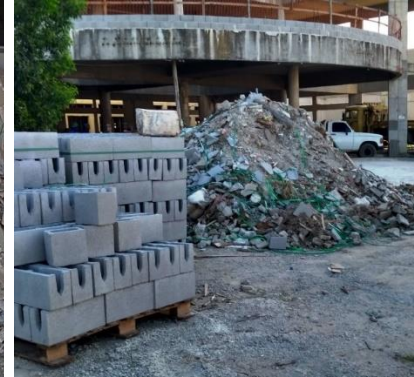
Figura 7: Resíduos de argamassa, blocos e concreto
