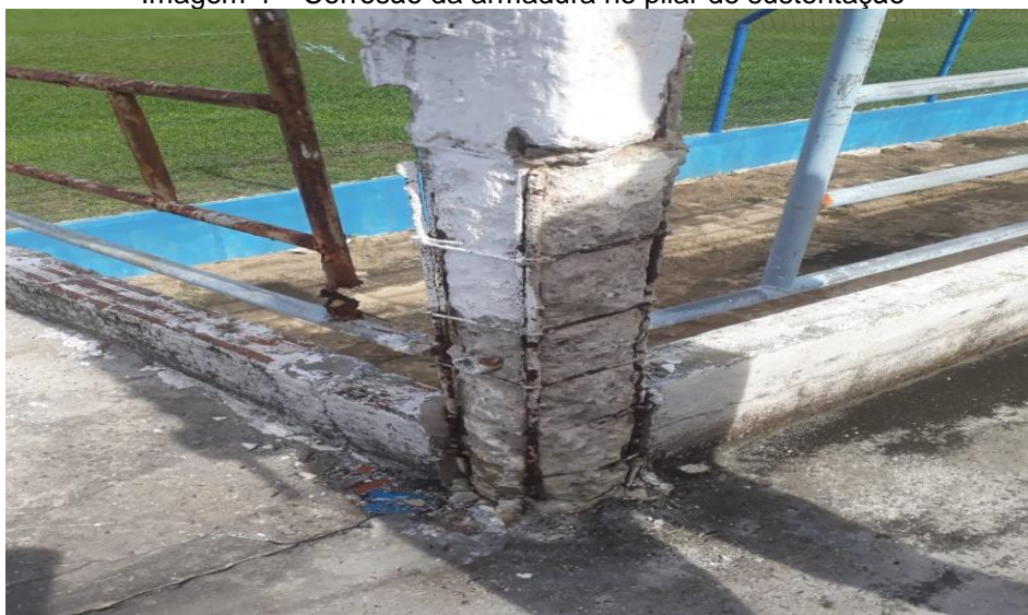
Imagem 4 – Corrosão da armadura no pilar de sustentação
