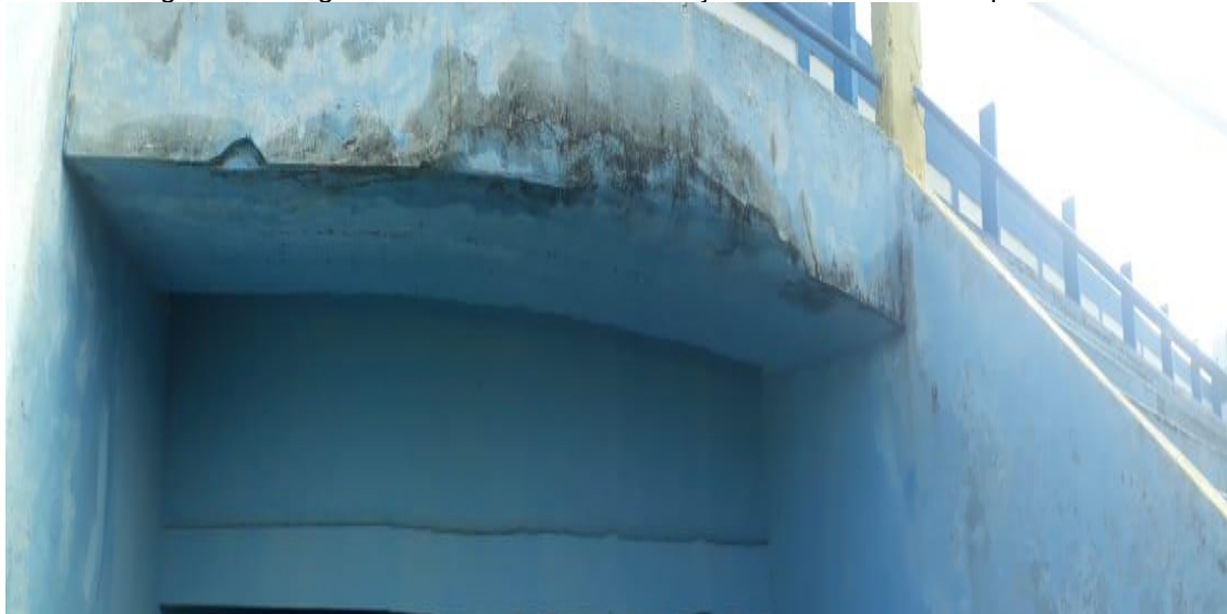
Imagem 6 – Surgimento de manchas e infiltrações nas saídas da arquibancada
