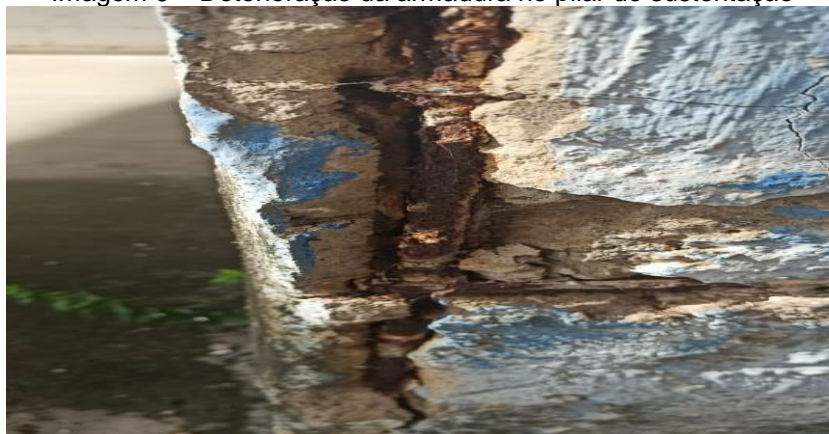
Imagem 9 – Deterioração da armadura no pilar de sustentação
