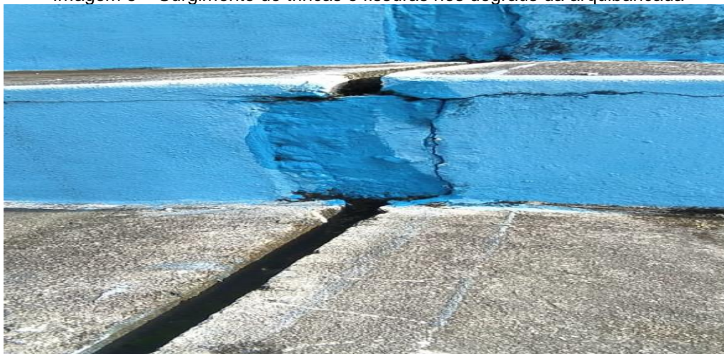
Imagem 5 – Surgimento de trincas e fissuras nos degraus da arquibancada
