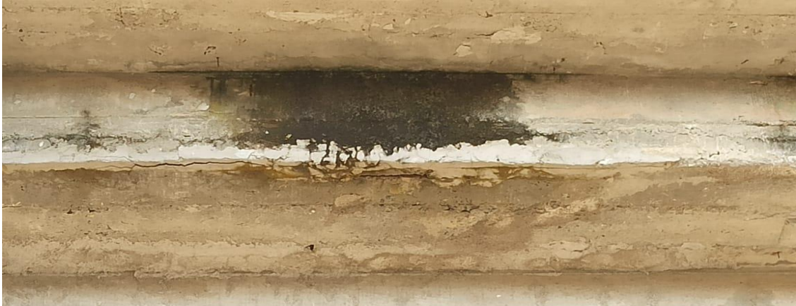
Imagem 7 – Ações por infiltração na estrutura da arquibancada
