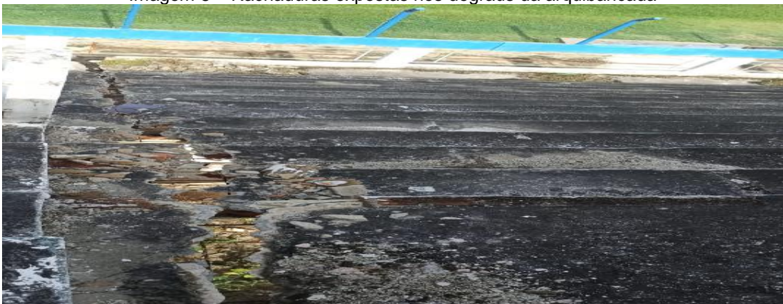
Imagem 8 – Rachaduras expostas nos degraus da arquibancada
