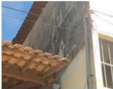
Mancha, efflorescência e bolor na alvenaria
