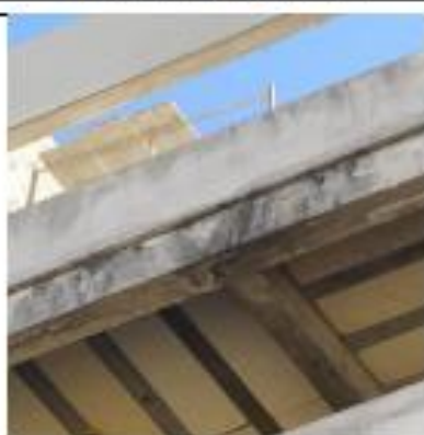
Viga com infiltração, mancha, fissura e corrosão
