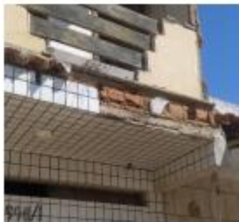
Fachada em degradação avançada
