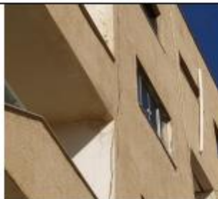
Mancha e fissura na fachada do edifício
