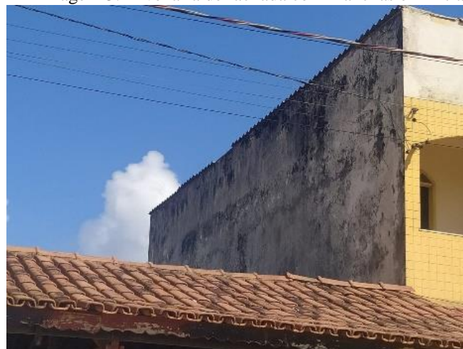
Imagem 3: Alvenaria de fachada com manchas e infiltração
