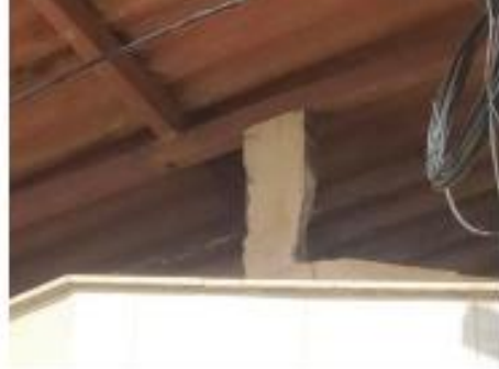
Viga com ferragem exposta e deslocamento
