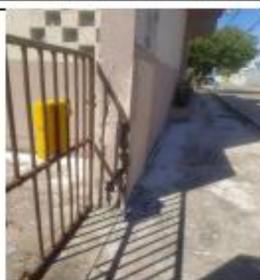
Corrosão de pilar com deslocamento
