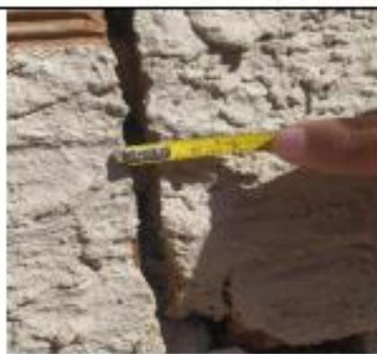
Rachadura com mais de 1cm
