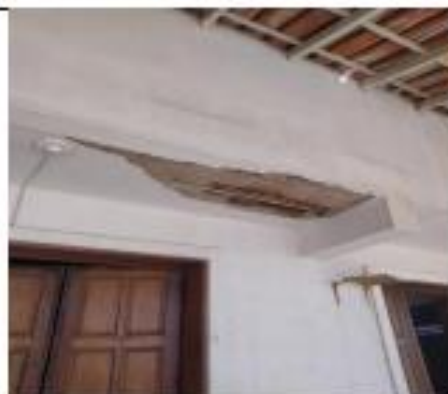
Deslocamento com ferragem exposta
