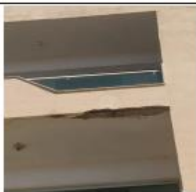
Deslocamento e corrosão
