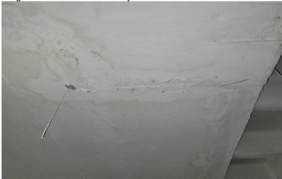
Figura 6 - Processo de lixiviação em estrutura de concreto armado
