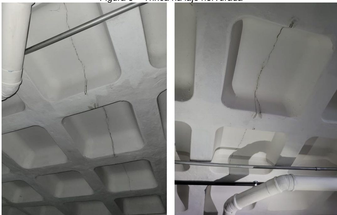
Figura 9 – Trinca na laje nervurada
