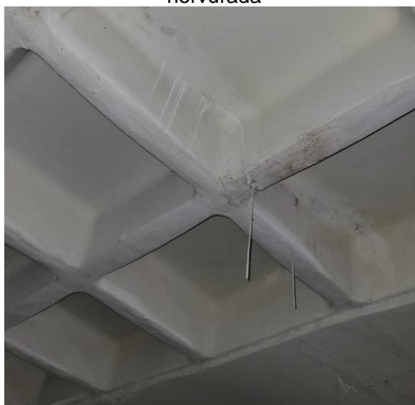
Figura 10 - Processo de lixiviação na laje nervurada
