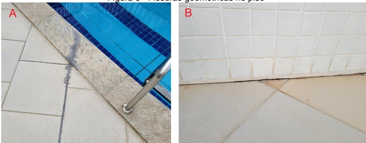
Figura 8 - Fissuras geométricas no piso
