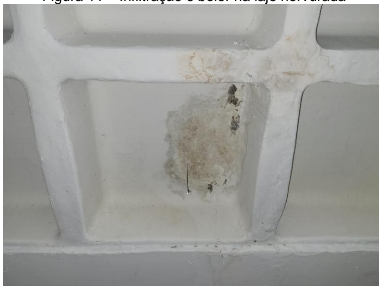
Figura 11 – Infiltração e bolor na laje nervurada
