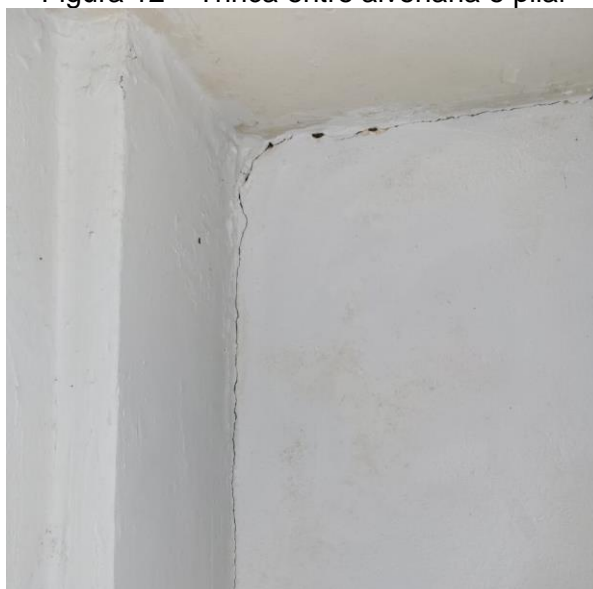
Figura 12 – Trinca entre alvenaria e pilar
