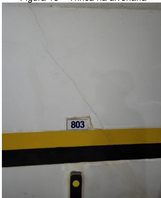
Figura 13 – Trinca na alvenaria
