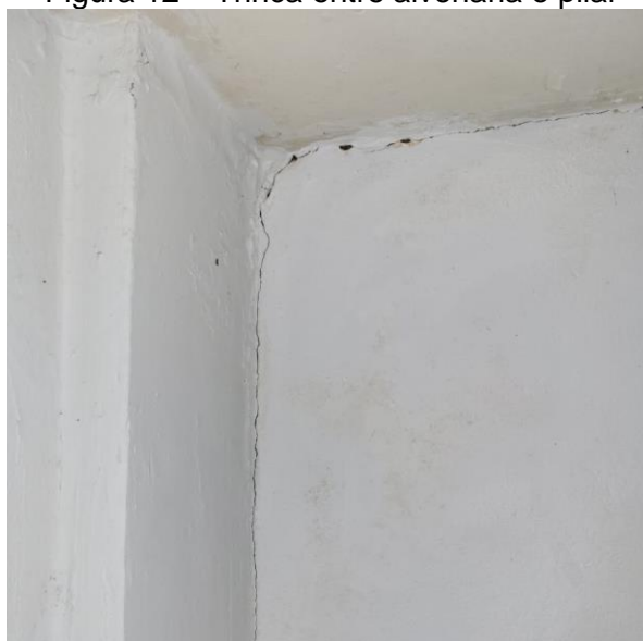
Figura 12 – Trinca entre alvenaria e pilar
