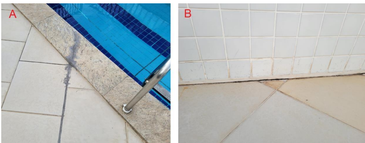
Figura 8 - Fissuras geométricas no piso
